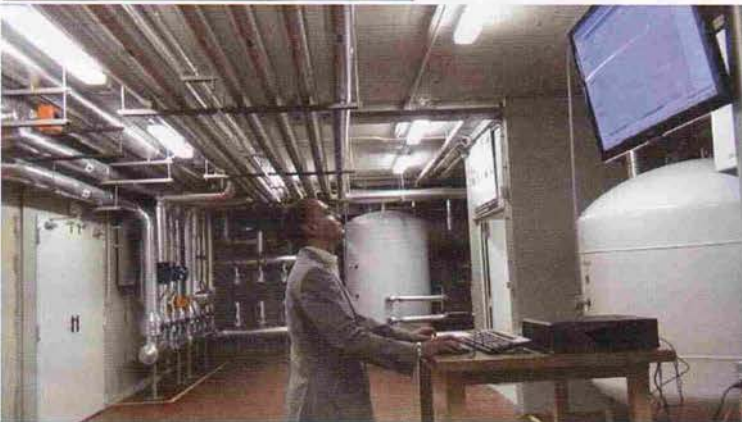
Ubicado en la sala de máquinas, el software de control completo de la instalación. Se comprobó la perfecta lectura y fácil uso de éste.
