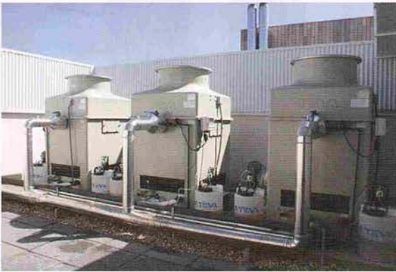
Torres de refrigeración conectadas a la máquina de absorción
