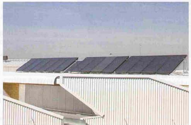
Placas solares: 70m 2 instalados
