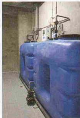
Sistema de aprovechamiento de aguas grises
