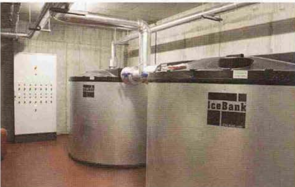
Depósito de acumulación de 8 m 3 de PCM (500 kWh)
